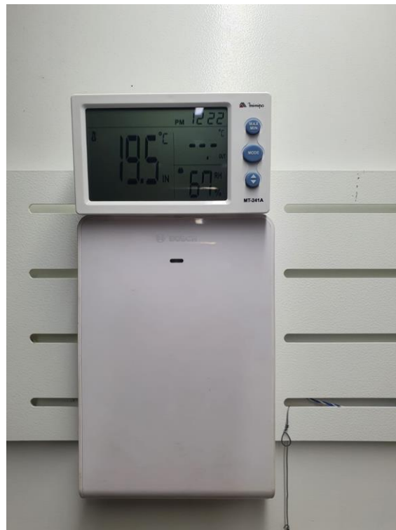
Figura 44: Sistema de monitoramento ambiental – Parte interna
