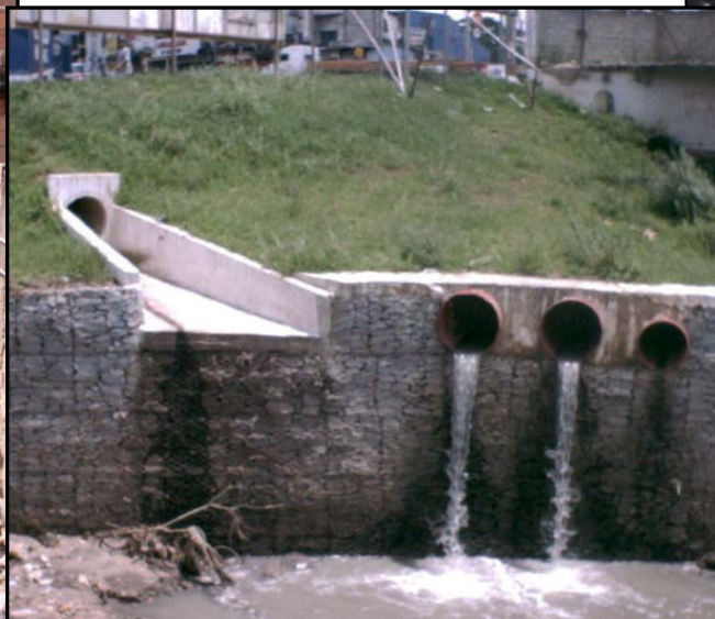
Poluição por Esgotos
